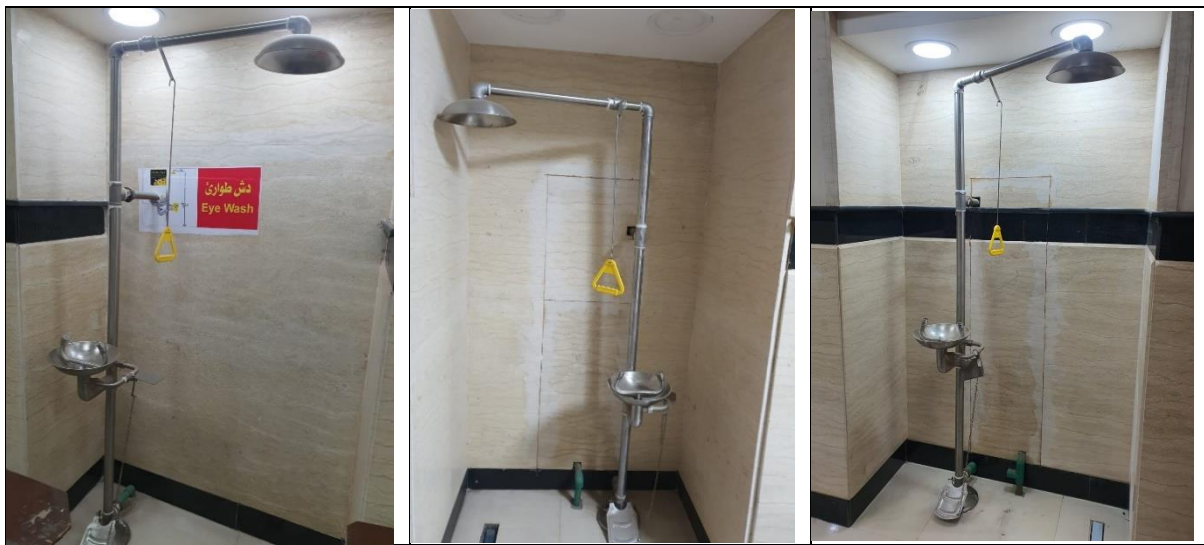
صورة 13: دش طوارئ بمبنى البيولوجي بكلية العلوم
