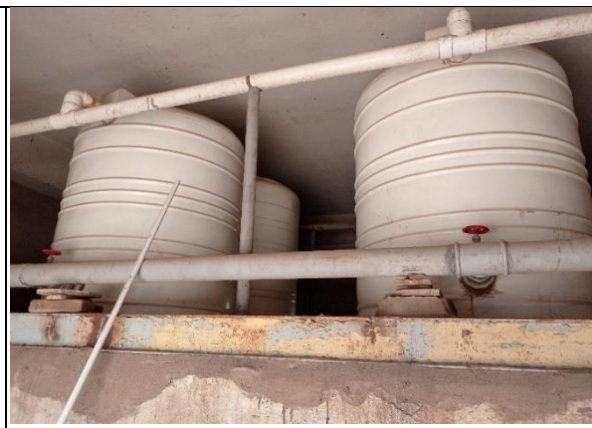
مثال على الحفاظ على المياه – خزانات المياه
