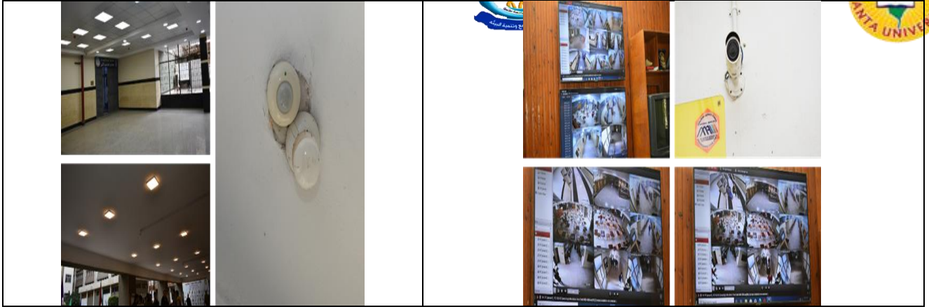
صورة 9: كاميرات المراقبة وكشافات الإضاءة وحساسات الإضاءة
