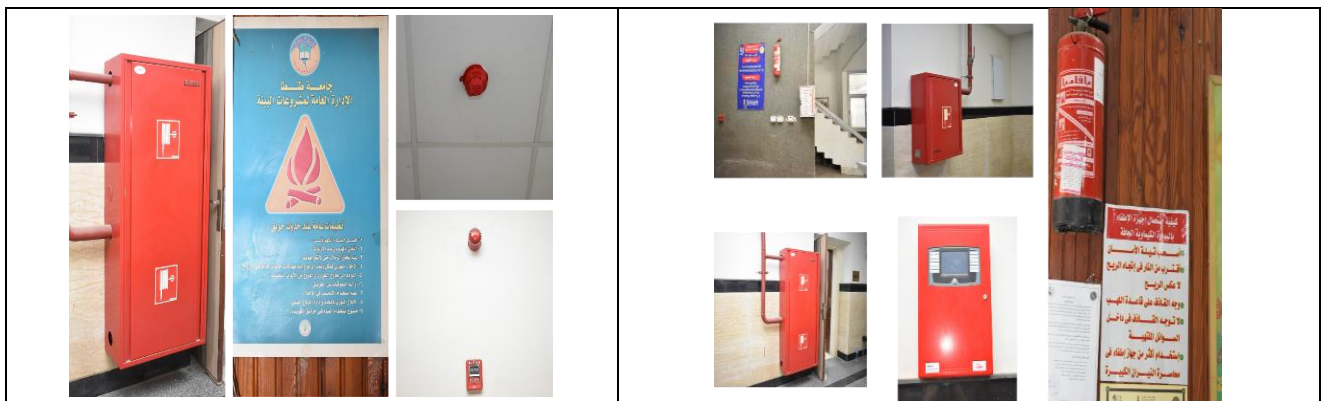
صورة 8: طفايات الحريق وخراطيم الإطفاء والإنذارات وخراطيم المياه وإرشادات الحريق
